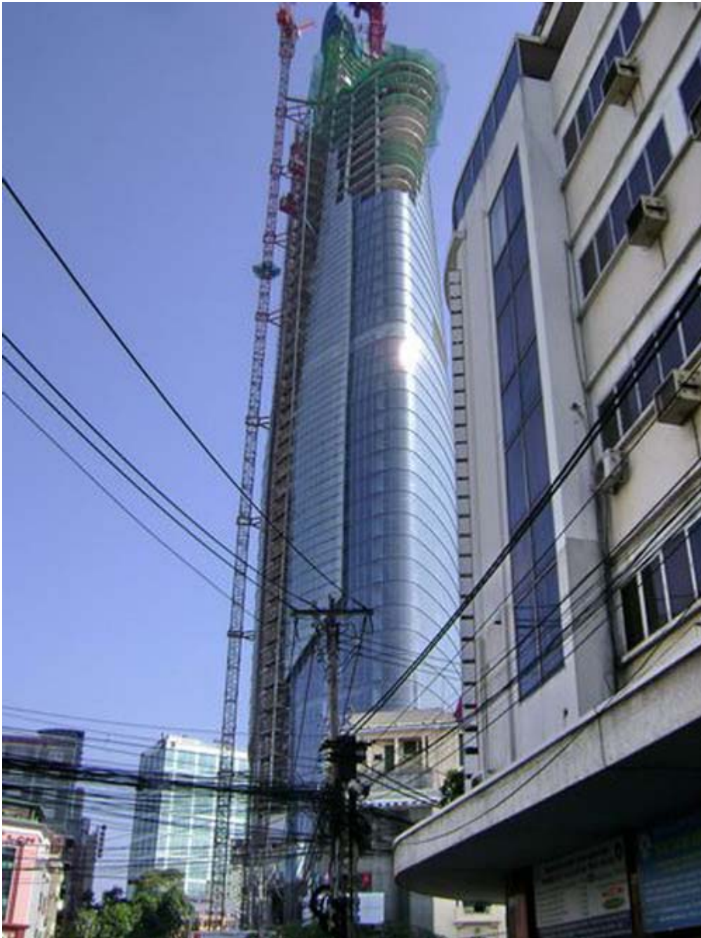
Tòa tháp Bitexco Financial Tower đang xây tới tầng thứ 57, khi hoàn tất sẽ cao 68 tầng và là tòa tháp cao nhất Sài Gòn.
